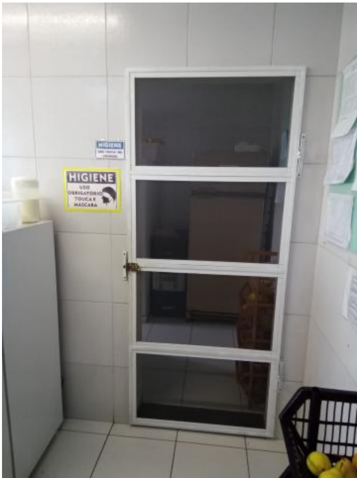
MELHORIAS NA UNIDADE - PORTA DE TELA DA COZINHA
